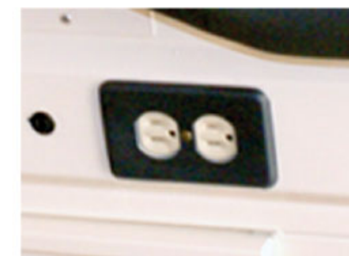
Sistema eléctrico para toma de corriente.
